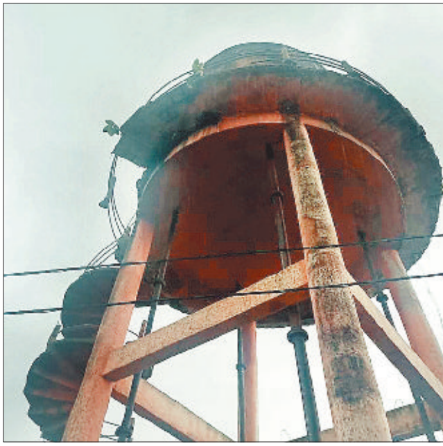
जर्जर पानी टंकी।
